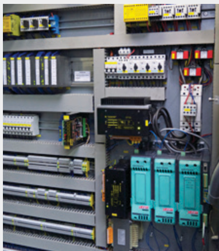
Bild 3: Einbausituation im Schaltschrank (Quelle: amTec Furnace Technologies GmbH)
